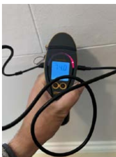
Fuktmerker i himling i gang, ved fuktmåletaking var det fuktutslag
