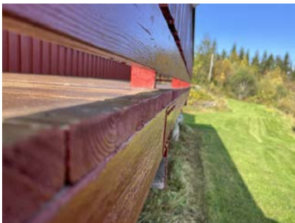
Skjevheter i terrasse
