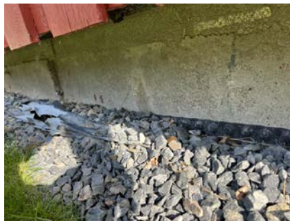
Synlig dreneringsplatt er lav og dels under terreng
