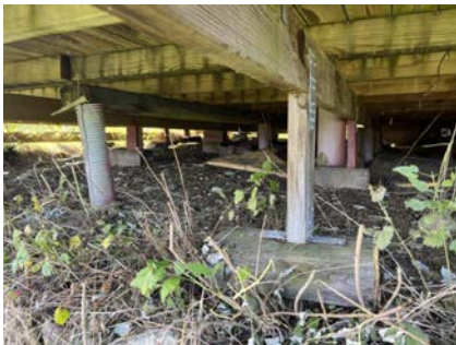
Enkel fundamenter på terreng som må skiftes
