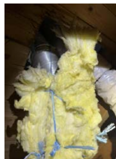
Avtrekksrør er ikke tilstrekkelig isolert og ikke ført tilstrekkelig over tak
