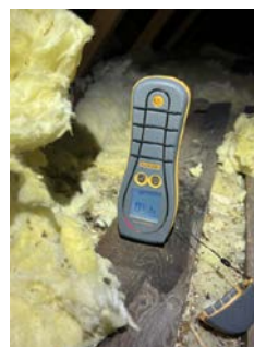
Bemerket fukt i konstruksjon under avtrekksrør og ved fuktmåletaking var det fuktutslag
