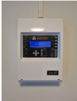
Felles brannsentral i felles gang ved hovedinngang
