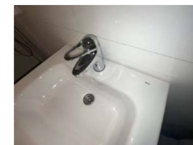
Anbefaler å montere mykfuge i overgang vegg og servant.
