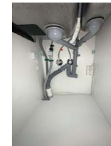
Det er montert vannføler i benkeskap under vask mot gulv ved oppvaskmaskin som sikring for evt. lekkasje
