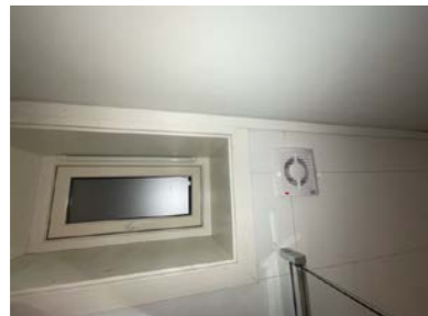
Mekanisk avtrekksvifte på vegg og åpningsvindu med ventil
