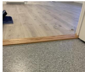
Flat terskel med tilluft er montert etter befaringen. Det ble da også fuget mellom belegget og dørterskel for å bedre vannsikkerheten.
