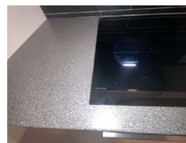
Sprekk på fremre hjørne av induksjonstopp
