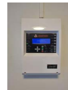
Felles brannsentral i felles gang ved hovedinngang
