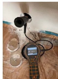
Fuktmåling i vegg mot våtsone.
