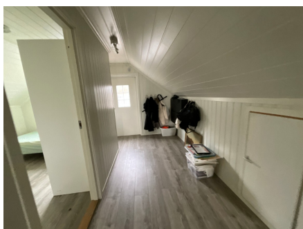
Skjevheter registrert i platetaket på loftet.
