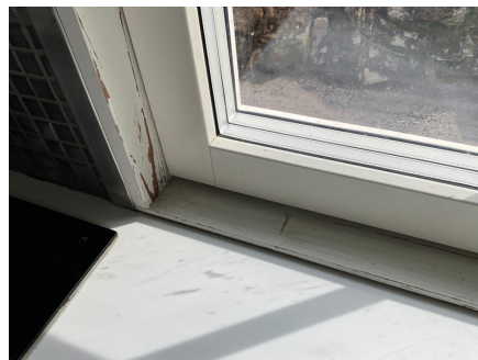
Fuktskader i karmen.
