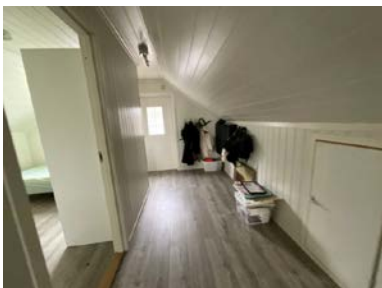
Skjevheter registrert i platetaket på loftet.
