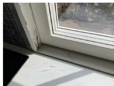
Fuktskader i karmen.
