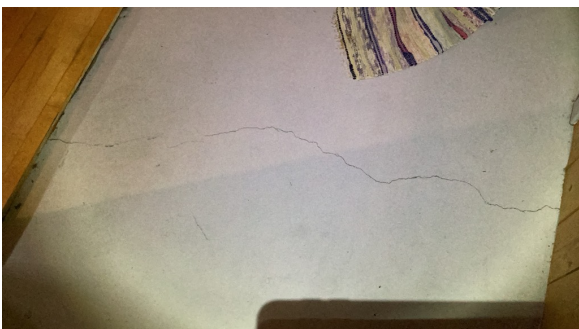
Riss/sprekker i gulv.
