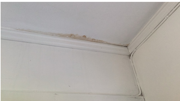
Fuktmerker i himling på kjøkken.
