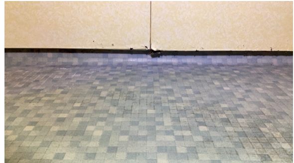
Fuktskader på plater.
