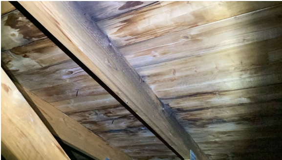
Misfarging på undertaksbord.
