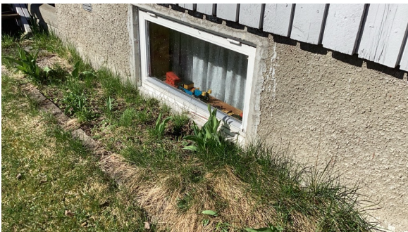
Lav høyde mellom terreng og kjellervinduer.
