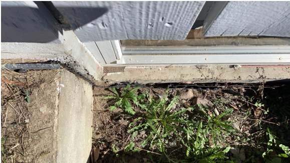
Grunnmursplast mangler avslutningslist.
