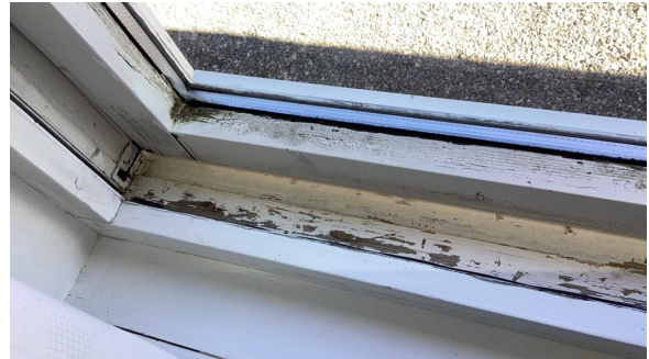
Slitasje og muggdannelse på vindu.
