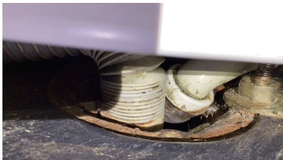
Rust i sluk.
