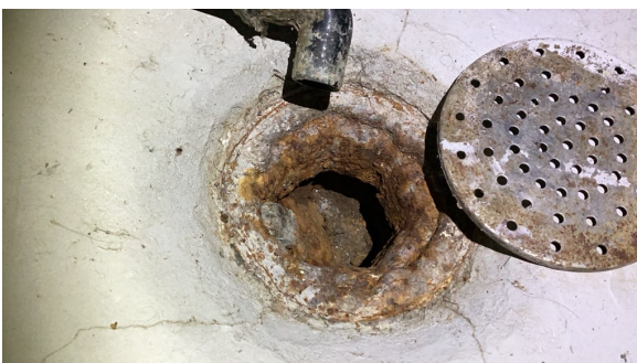
Rust i sluk.
