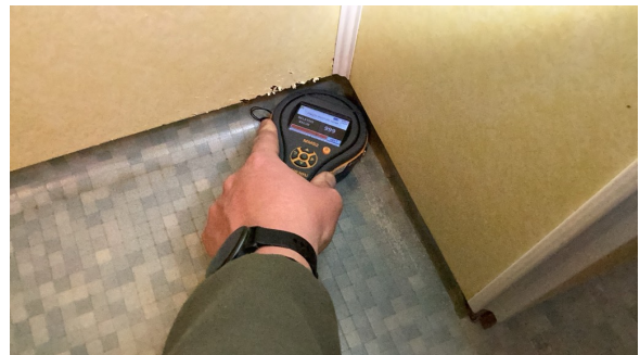
Ved bruk av fuktindikator registrerte jeg unormale verdier på utsatte steder.
