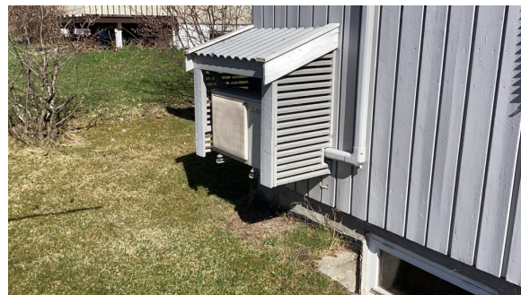
Vann fra varmepumpe bør ledes vekk fra grunnmur.
