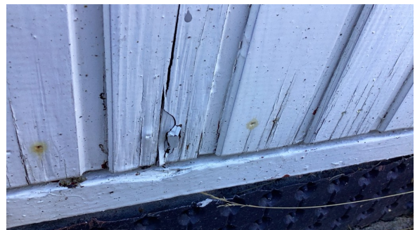
Råte observert på ytterdør ned til kjeller.
