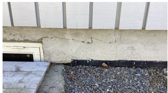
Selgers opplysning: Sprekk i mur har vært der siden vi bygde.
