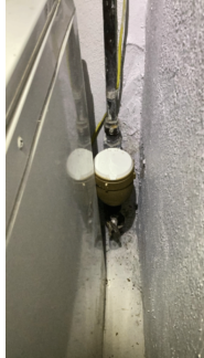
Hovedstoppekran på teknisk rom.
