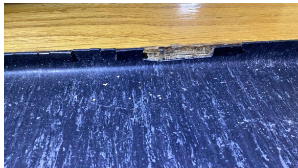
Ødlagt belegg ved dør.
