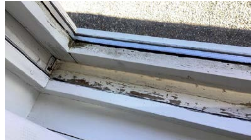
Slitasje og muggdannelse på vindu.
