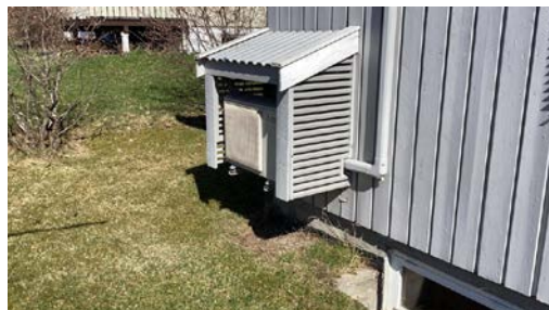
Vann fra varmpumpe bør ledes vekk fra grunnmur.
