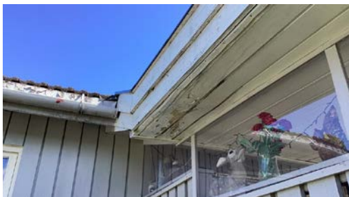
Svelling på himlingsbord på overbygd det.
