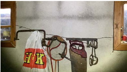
Selgers opplysning: Sprekk i mur har vært der siden vi bygde.
