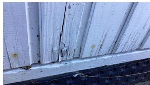
Råte observert på ytterdør ned til kjeller.
