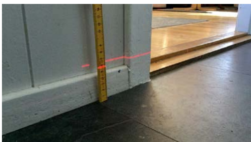
Helningsavvik ble målt til 17 mm på kjøkken.
