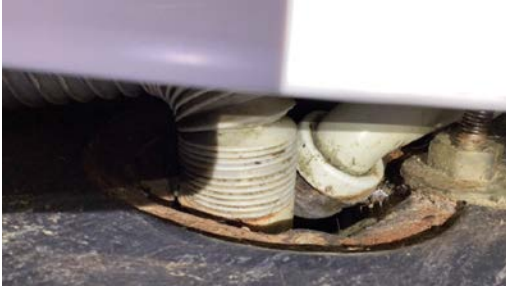
Rust i sluk.
