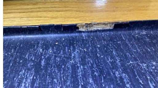
Ødlagt belegg ved dør.
