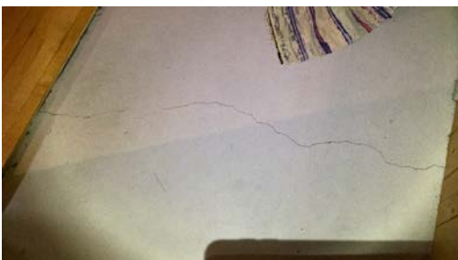
Riss/sprekker i gulv.
