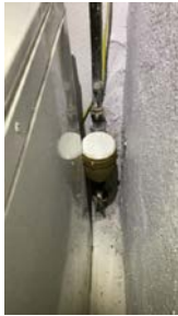
Hovedstoppekran på teknisk rom.
