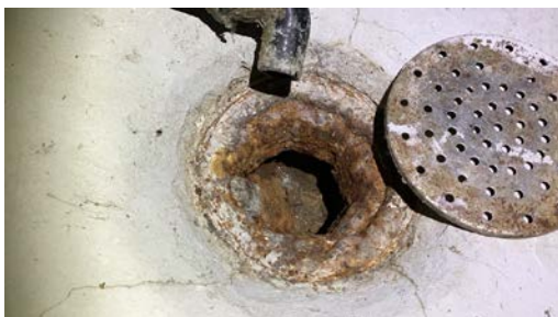
Rust i sluk.
