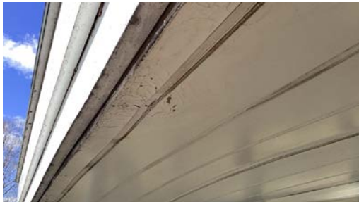
Svelling på himlingsbord på overbygd det.
