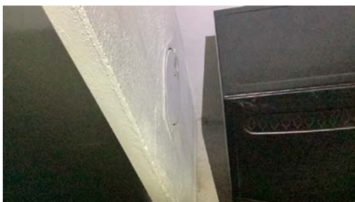
Feieluke på teknisk rom.
