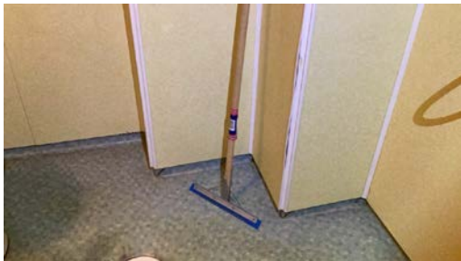
Fuktskader på plater.
