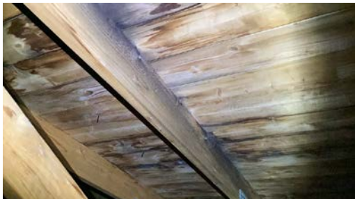
Misfarging på undertaksbord.
