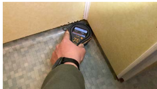
Ved bruk av fuktindikator registrerte jeg unormale verdier på utsatte steder.
