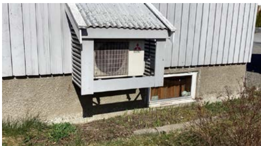
Vann fra varmpumpe bør ledes vekk fra grunnmur.
