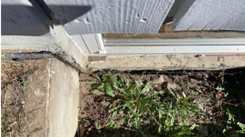
Grunnmursplast mangler avslutningslist.
