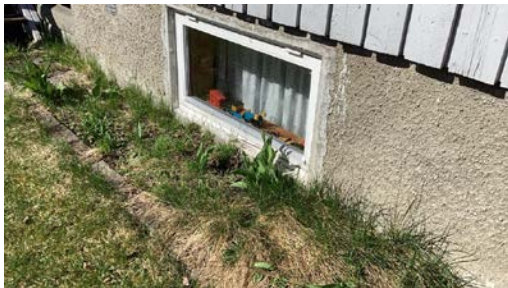
Lav høyde mellom terreng og kjellervinduer.
