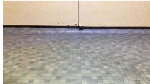
Fuktskader på plater.
