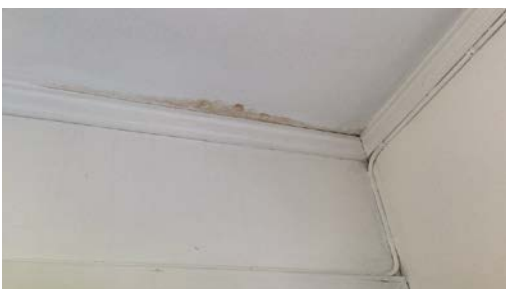
Fuktmerker i himling på kjøkken.
