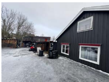
Isdannelser på tekking/ dekke over næring
