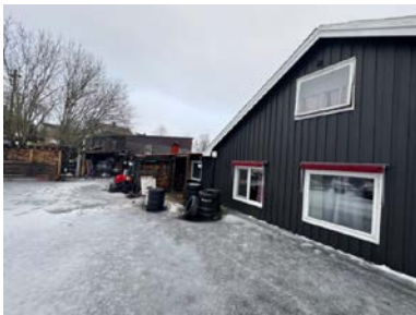
Isdannelse på tekking/ dekke over næring
