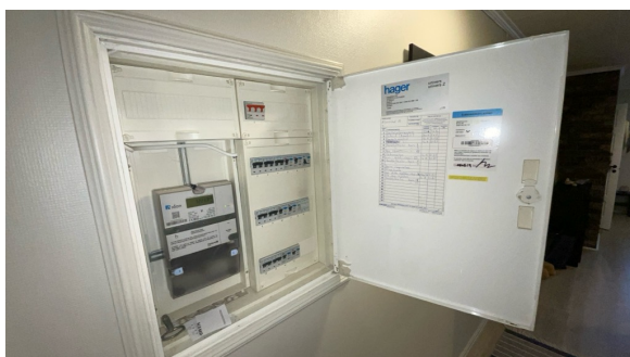
Sikringsskap i hybelen
