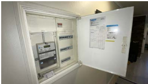
Sikringsskap i hybelen
