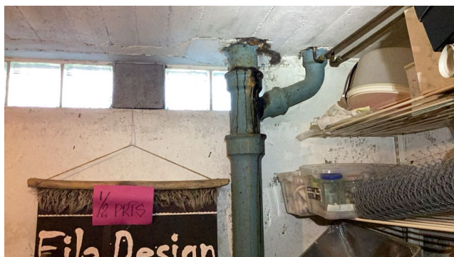
Svetting i skjøter, rør bør skiftes
