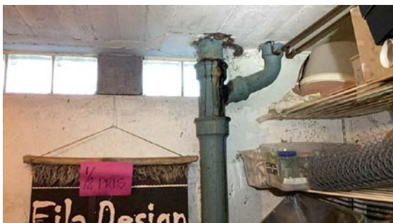
Svetteing i skjøter, rør bør skiftes
