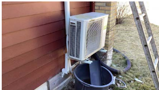
Varmepumpe for gulvvarme og varmluft i stue. En del susing i stue.
