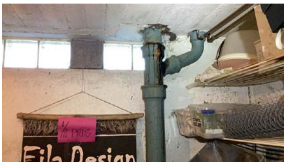
Svetting i skjøter, rør bør skiftes
