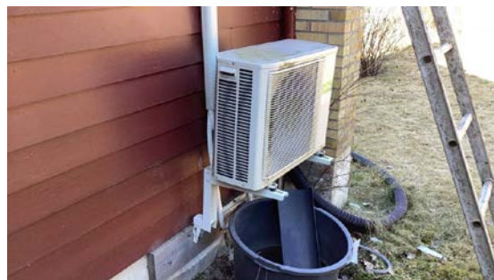
Varmepumpe for gulvvarme og varmluft i stue. En del susing i stue.
