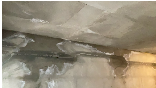
Fuktmerker i garasjen.
