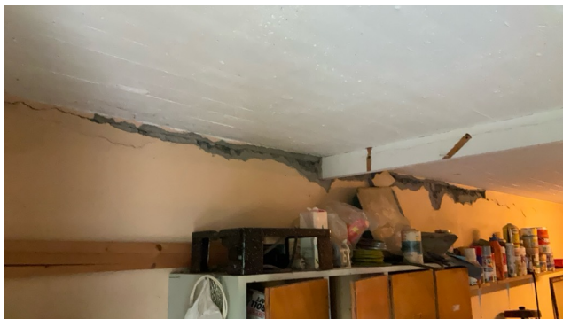
Sprekker i muren/deleveggen mellom garasjen og bod/hobbyrommet.
