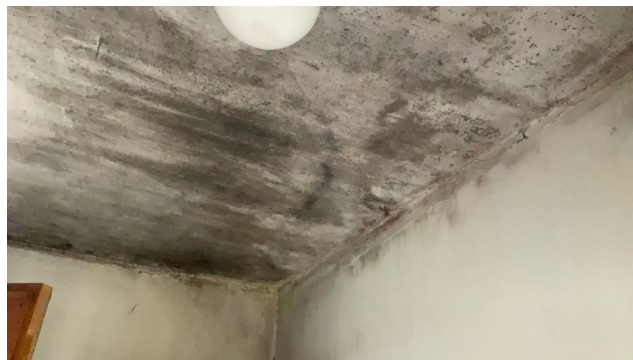
Fuktmerker i entre i U. etasje.
