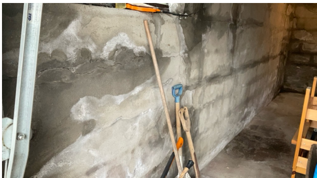
Sprekker i muren i garasjen.
