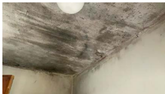
Fuktmerker i entre i U. etasjen.
