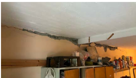
Sprekker i muren/delevegg mellom garasjen og bod/hobbyrommet.
