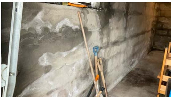
Sprekker i muren i garasjen.
