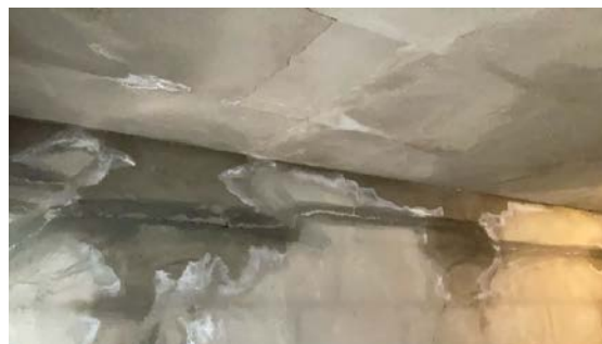
Fuktmerker i garasjen.
