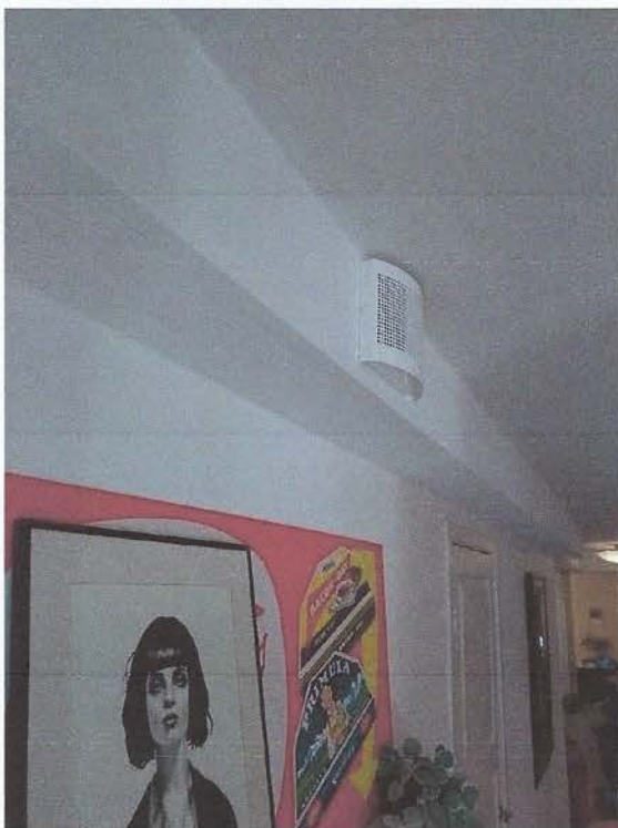
Bilde 1: Bildet viser hvordan rørføring og ventil for tillyft er utført i en leilighet. Rørene er kasset inn for å lage estetisk pene løsninger.
