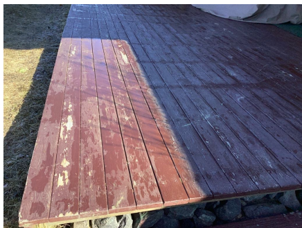
Eksempel på slitasje på gulv.
