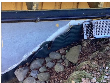
Fuktsperre har ikke klemt avslutning.
