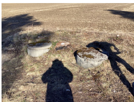
Brønn og kum med pumpe og trykktank.
