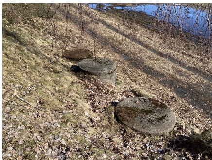
Kloakkanlegg med trekummer.
