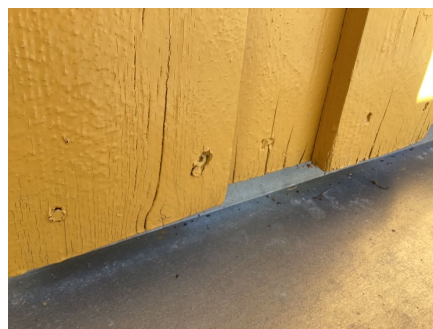
Eksempel på sprekk i kledningsbord.
