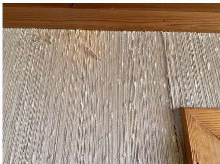
Misfarging og sprekk i vegg.
