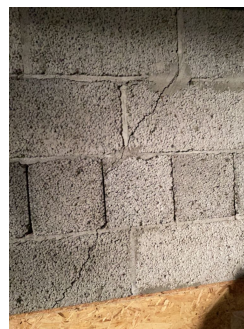
Sprekk i grunnmur på vedskåle.
