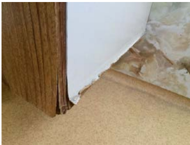
Skade på servantinnredning.
