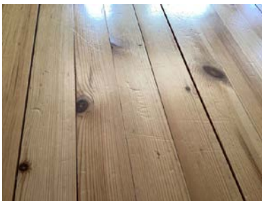
Eksempel på tilstand på tregulv.
