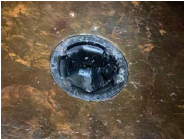
Sluk med klemring i tilslutning til gulvbelegg.
