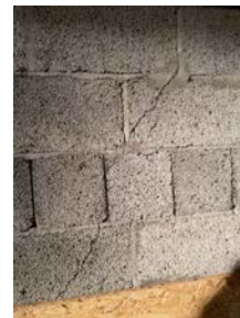
Sprekk i grunnmur på vedskåle.
