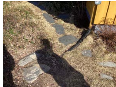
Eksempel på takvann som ledes ned i bakken.
