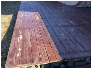
Eksempel på slitasje på gulv.
