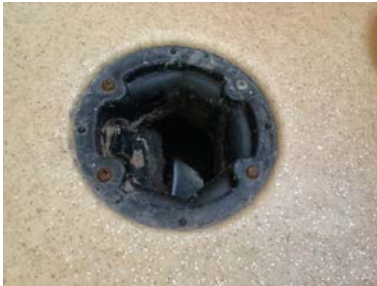
Sluk av plast med klemring.
