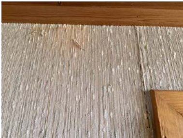
Misfarging og sprekk i vegg.
