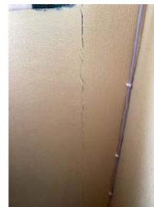
Sprekk i overflate på soverom.
