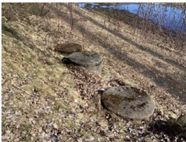
Kloakkanlegg med trekummer.
