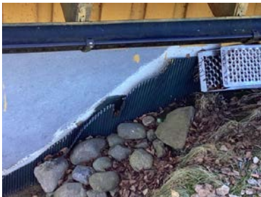
Fuktsperre har ikke klemt avslutning.
