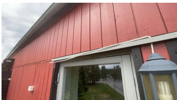
Utvendig kabel må festes
