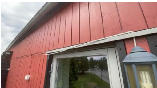
Utvendig kabel må festes
