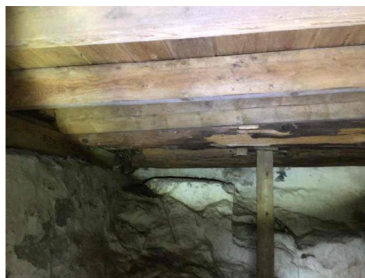
Råte i etasjeskille.
