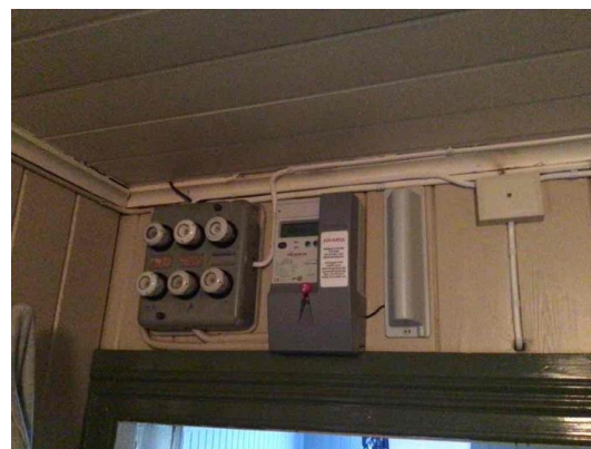
Sikringer og fjernavleser uten skap.
