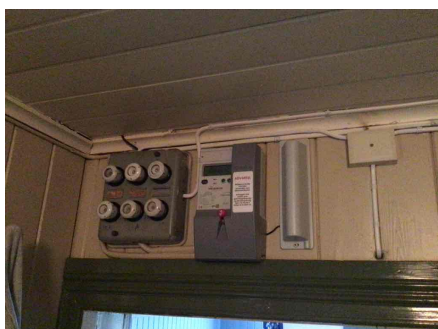
Sikringer og fjernavleser uten skap.
