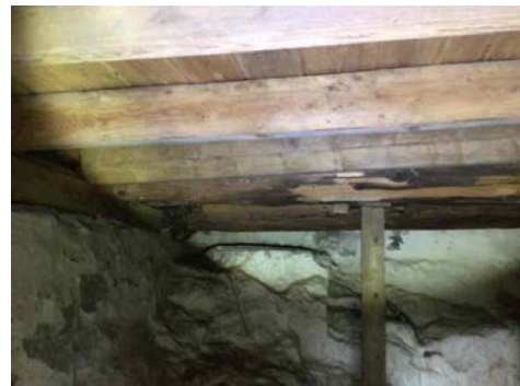
Råte i etasjeskille.
