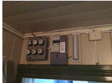
Sikringer og fjernavleser uten skap.
