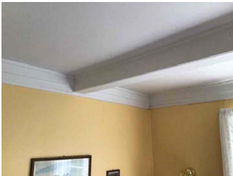
Del av innvendig overflate vegg - tak.
