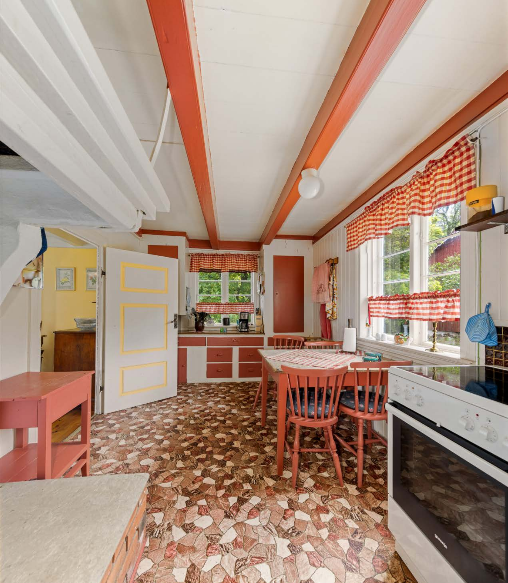
Kjøkkenet har gammel, plassbygd innredning i tre med glatte fronter og laminert benkeplate. Det er ikke innlagt vann og avløp.
