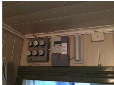
Sikringer og fjernavleser uten skap.
