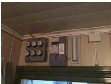
Sikringer og fjernavleser uten skap.
