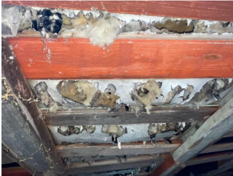
Synlig skader etter mus i stubbeloft
