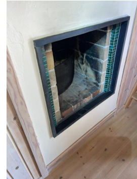
Manglende ildfast plate på gulv.
