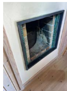
Manglende ildfast plate på gulv.
