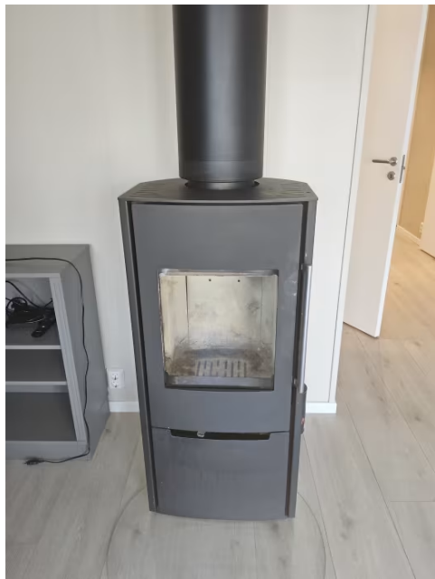
Vedovn med glassdør i stue.
