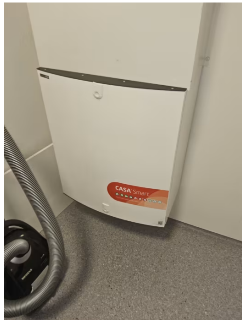
Ventilasjonsaggregat er plassert i bod/teknisk rom.
