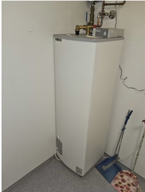
Varmtvannsbereder er plassert i bod/teknisk rom.
