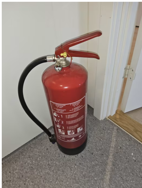
Brannslukningsapparat er plassert i bod/teknisk rom.
