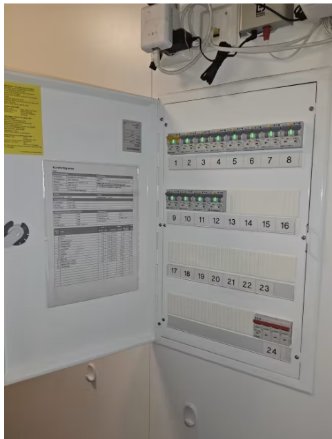
Sikringsskap er plassert i bod/teknisk rom.
