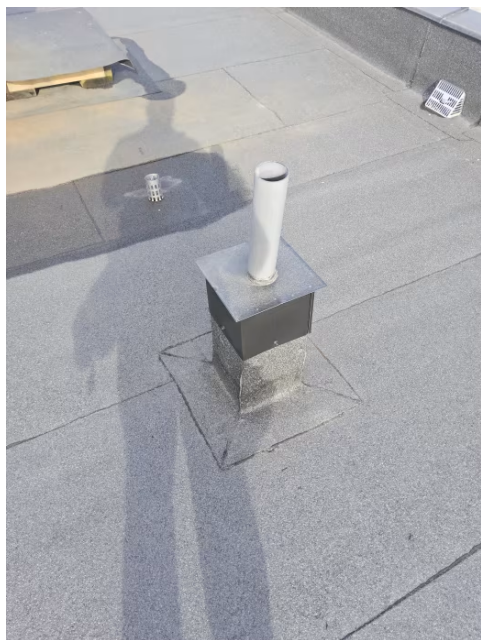
Avløpsanlegget er luftet over tak.
