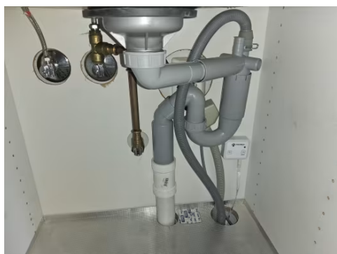
Rørapplegg under kjøkkenvask.
