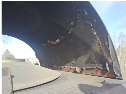
Regnhatt har flasket og rusten overflate.
