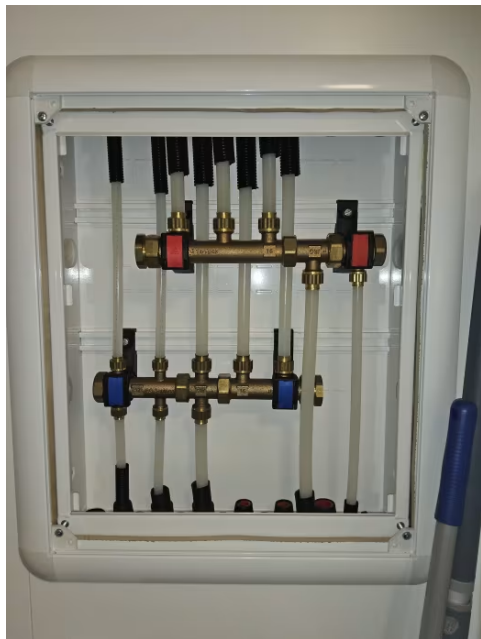
Fordelerskap er plassert i bod/teknisk rom.
