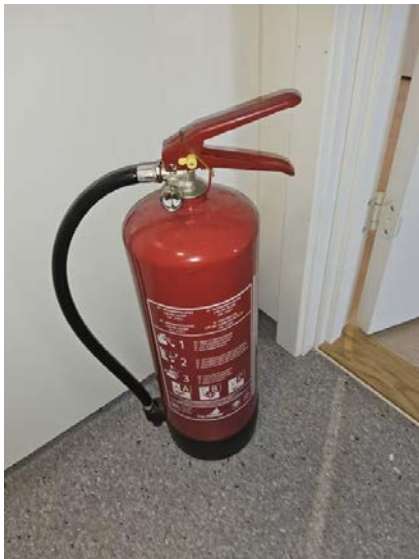
Brannslukningsapparat er plassert i bod/teknisk rom.
