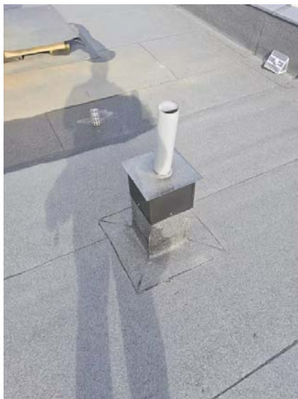
Avløpsanlegget er luftet over tak.
