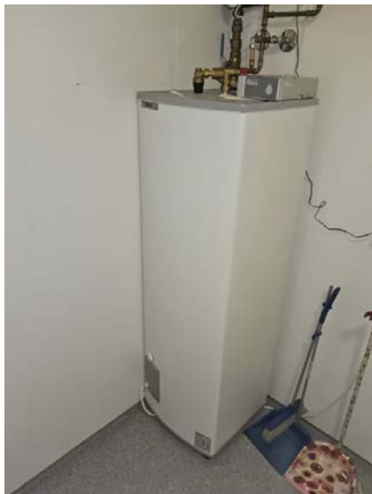
Varmtvannsbereder er plassert i bod/teknisk rom.
