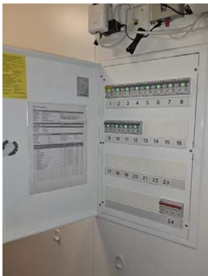
Sikringsskap er plassert i bod/teknisk rom.
