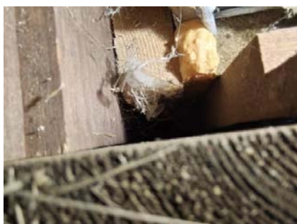
Det registreres manglende musesperre i ytterhjørner.
