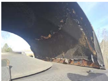
Regnhatt har flasket og rusten overflate.
