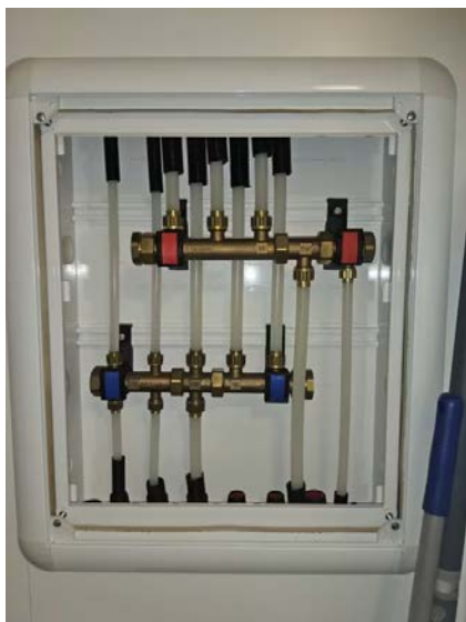
Fordelerskap er plassert i bod/teknisk rom.
