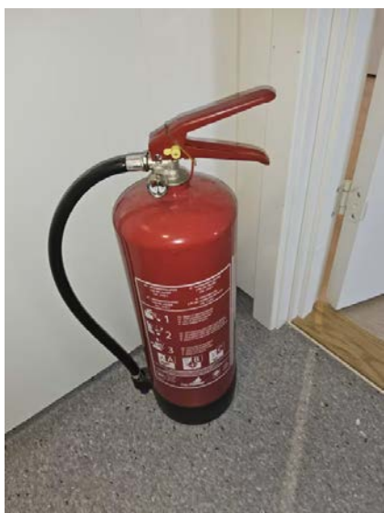
Brannslukningsapparat er plassert i bod/teknisk rom.
