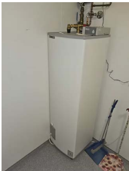
Varmtvannsbereder er plassert i bod/teknisk rom.
