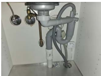
Rørapplegg under kjøkkenvask.
