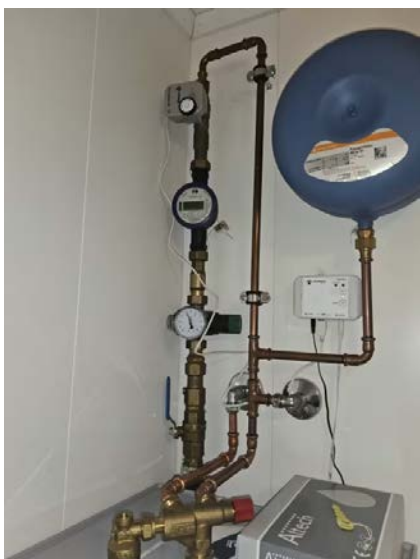
Hovedstoppekran, automatisk vannstoppeventil og vannmåler er plassert i bod/teknisk rom.
