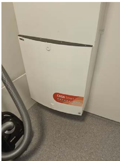
Ventilasjonsaggregat er plassert i bod/teknisk rom.
