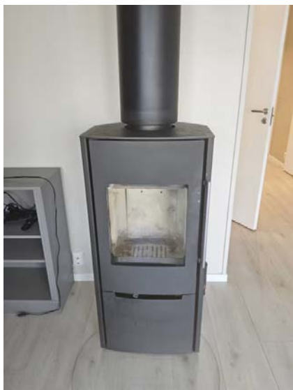
Vedovn med glassdør i stue.
