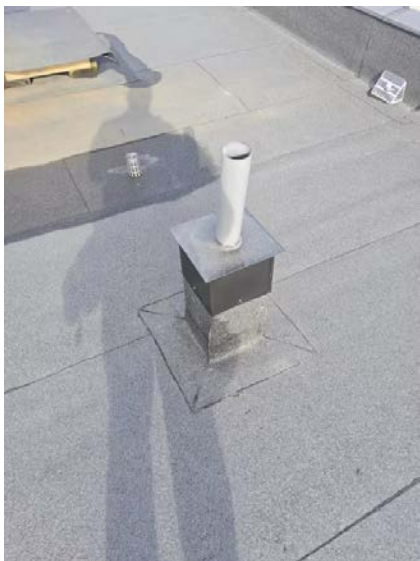
Avløpsanlegget er luftet over tak.
