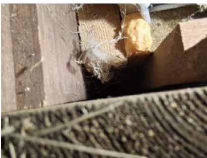
Det registreres manglende musesperre i ytterhjørner.
