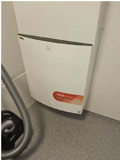
Ventilasjonsaggregat er plassert i bod/teknisk rom.
