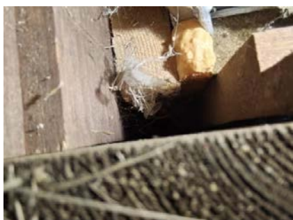
Det registreres manglende musesperre i ytterhjørner.
