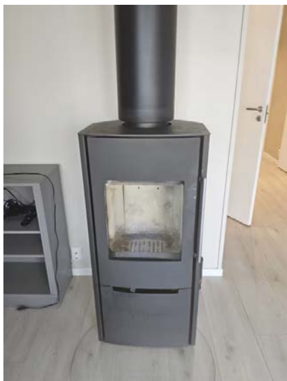
Vedovn med glassdør i stue.
