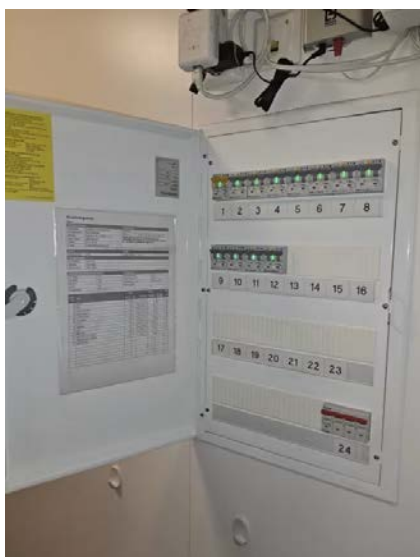
Sikringsskap er plassert i bod/teknisk rom.
