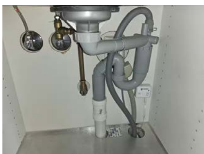
Røropplegg under kjøkkenvask.
