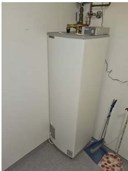
Varmtvannsbereder er plassert i bod/teknisk rom.
