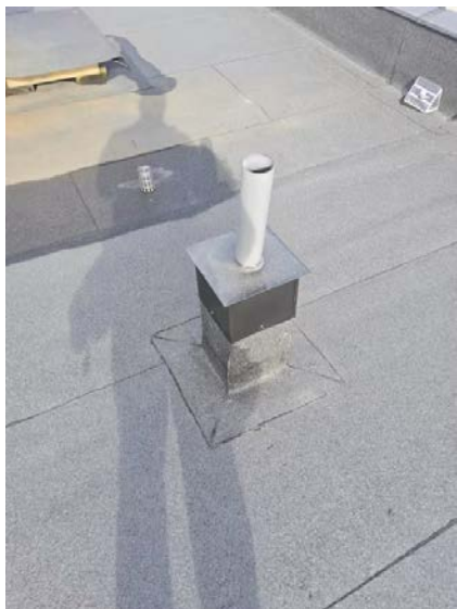
Avløpsanlegget er luftet over tak.
