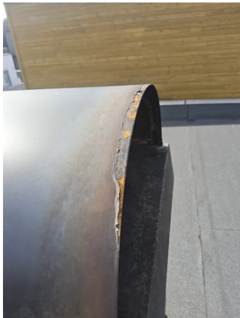
Bilde viser rust på pipehatt.
