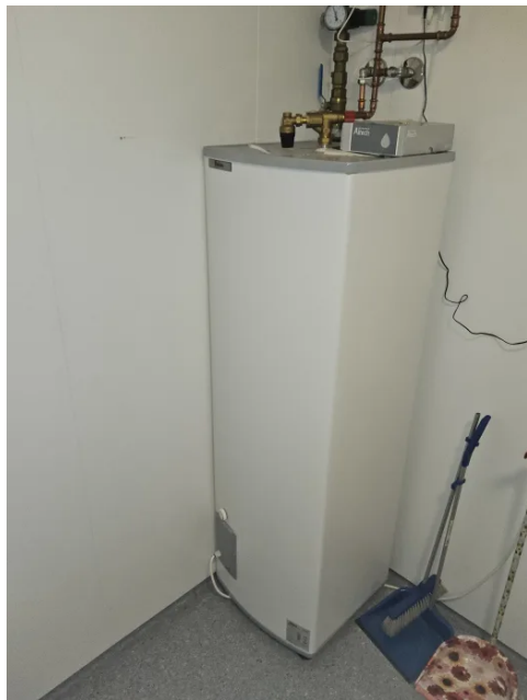
Bilde viser varmtvannsbereder.
