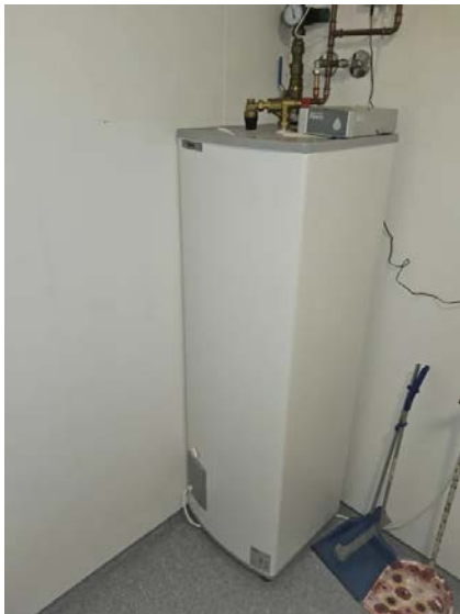
Bilde viser varmtvannsbereder.
