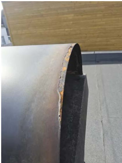
Bilde viser rust på pipehatt.
