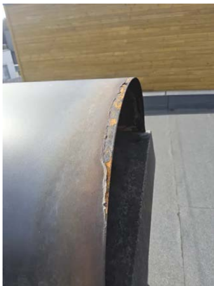
Bilde viser rust på pipehatt.
