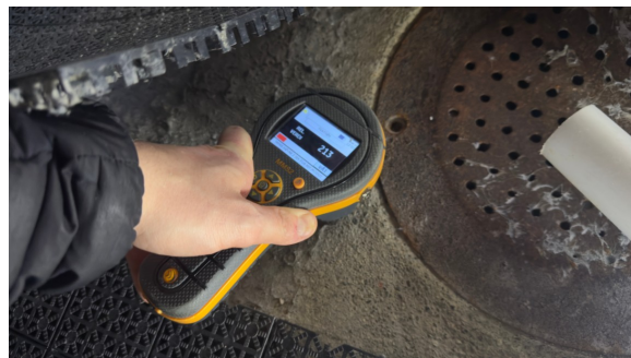
Det ble registrerte fuktverdier i gulvet.
