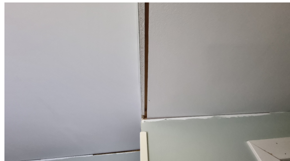
Manglende listverk / gjenstående arbeider.
