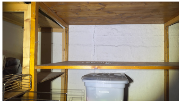
Innvendig sprekk i grunnmur.
