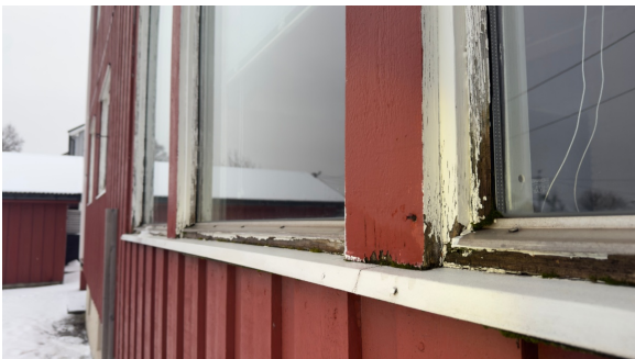
Det er påvist vinduer med fukt/råteskader.
