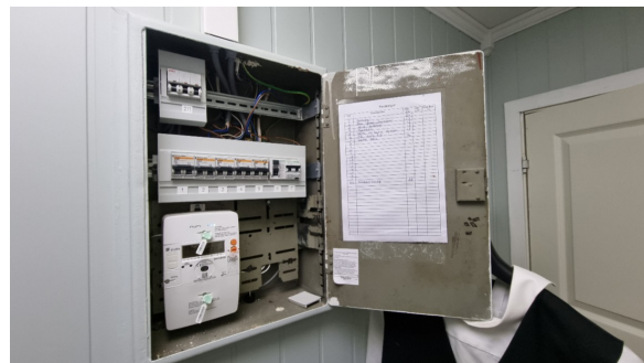
Kontroll av el-skap og kursfortegnelse 2. etasje
