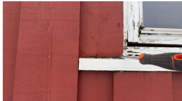
Det er registrert noe råteskade i omramming rundt enkelte vinduer.
