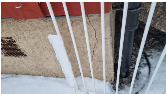
Utvendig sprekk i grunnmur.
