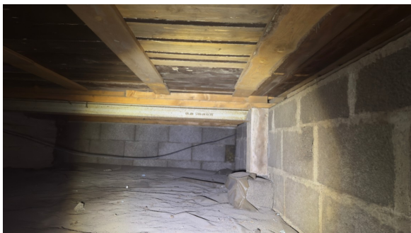
Ingen inspeksjonsmulighet utover gjennom ventilhull i grunnmur.
