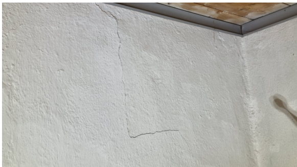
Innvendig sprekk i grunnmur.
