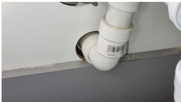
Det må tettes tilfredsstillende rundt rørgjennomføringer under servant.
