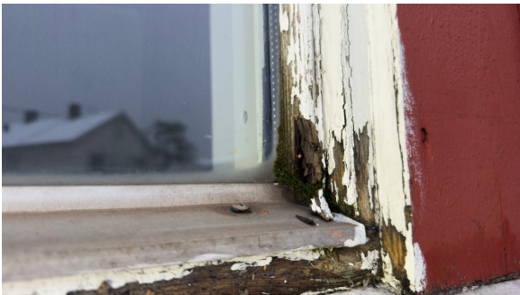
Det er påvist vinduer med fukt/råteskader.
