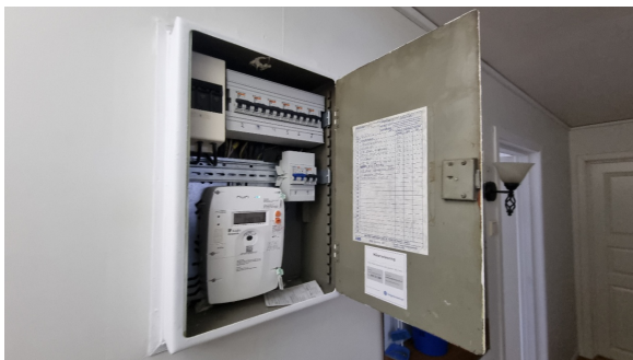
Kontroll av el-skap og kursfortegnelse 1. etasje
