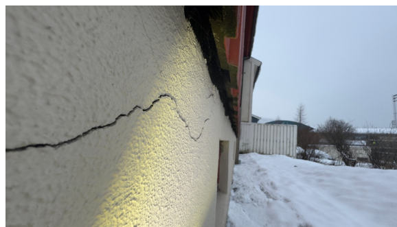
Utvendig sprekk i grunnmur.
