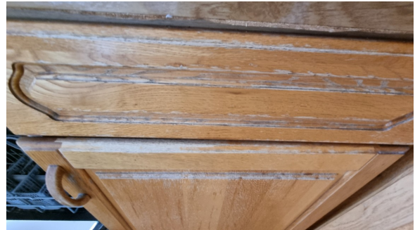
Fronter har noe overflateslitasje.
