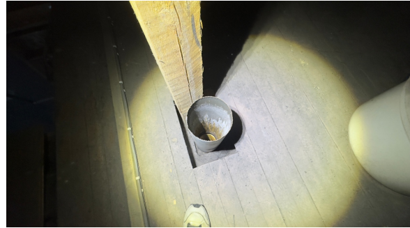
Avtrekket må ledes ut av bygningskroppen.
