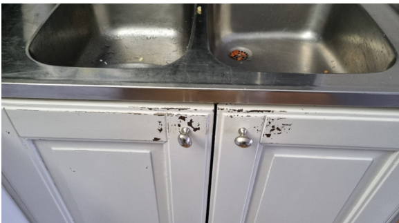
Overflateslitasje i fronter.
