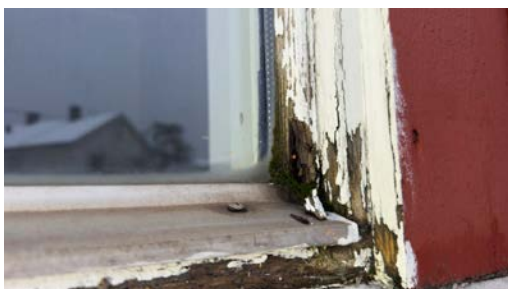
Det er påvist vinduer med fukt/råteskader.
