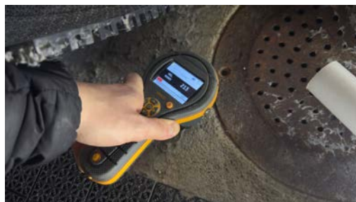
Det ble registrerte fuktverdier i gulvet.
