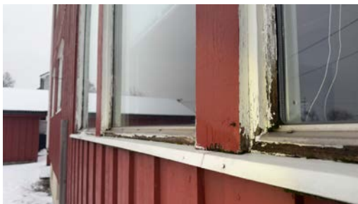
Det er påvist vinduer med fukt/råteskader.
