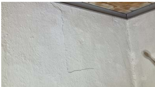
Innvendig sprekk i grunnmur.
