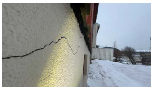
Utvendig sprekk i grunnmur.
