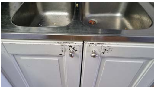
Overflateslitasje i fronter.
