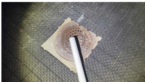
Soilsluk fra byggeår.
