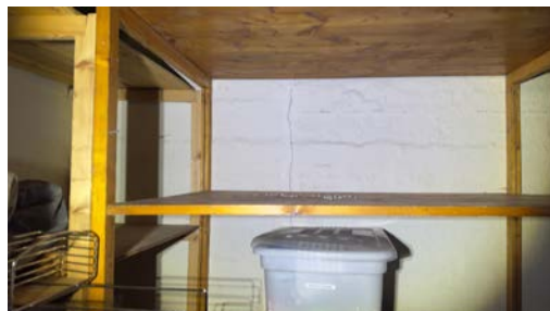
Innvendig sprekk i grunnmur.
