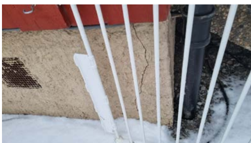
Utvendig sprekk i grunnmur.
