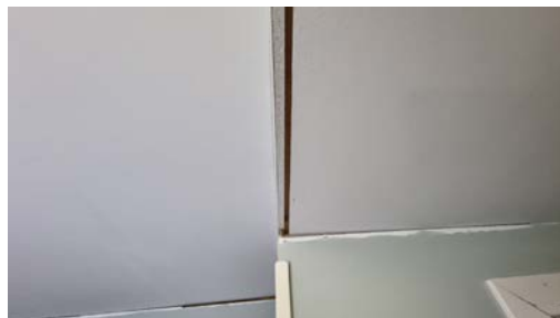
Manglende listverk / gjenstående arbeider.
