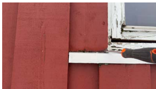
Det er registrert noe råteskade i omramming rundt enkelte vinduer.
