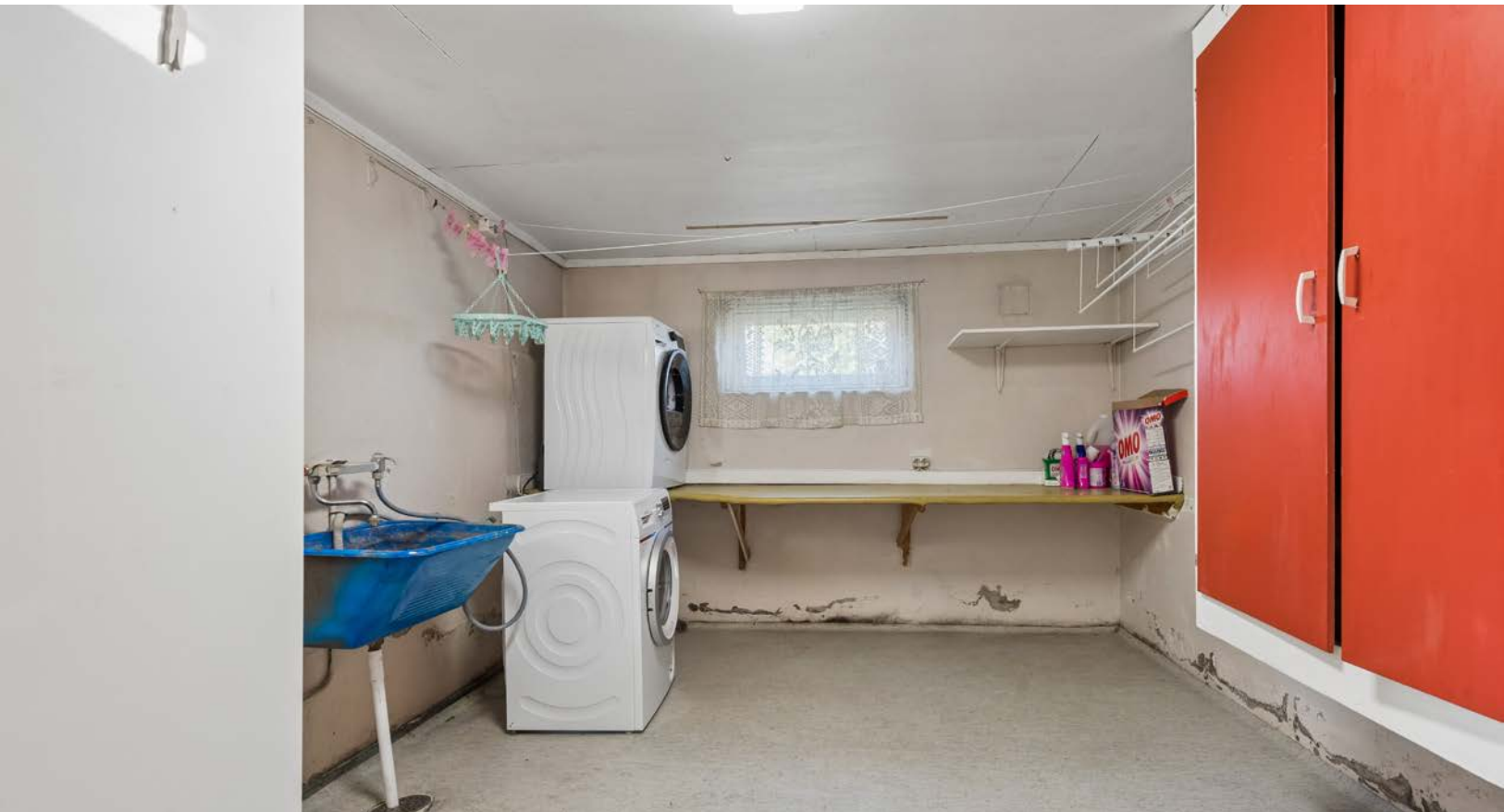
Vaskerom med eldre standard.
