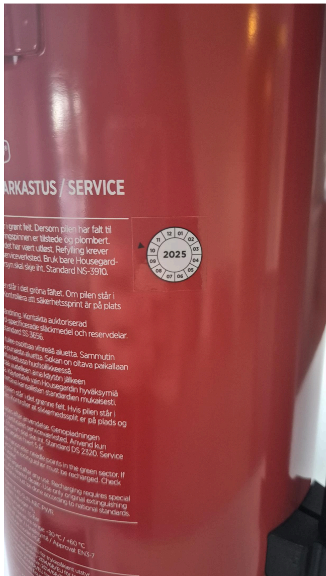
Pulverapparat fra 2025 plassert i bod
