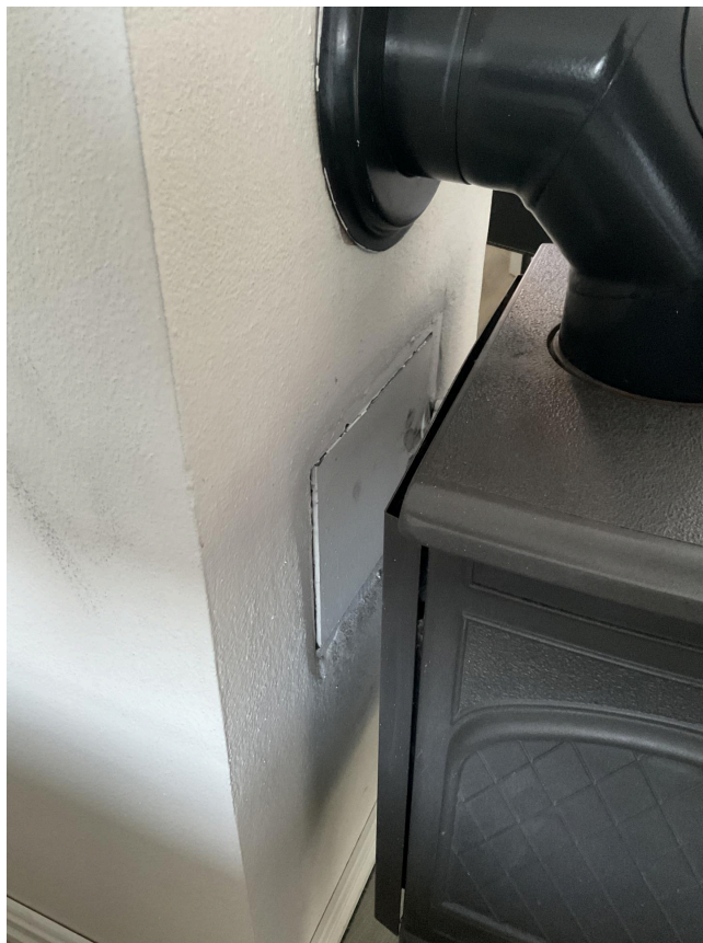
Bilde av feieluke bak vedovn.
