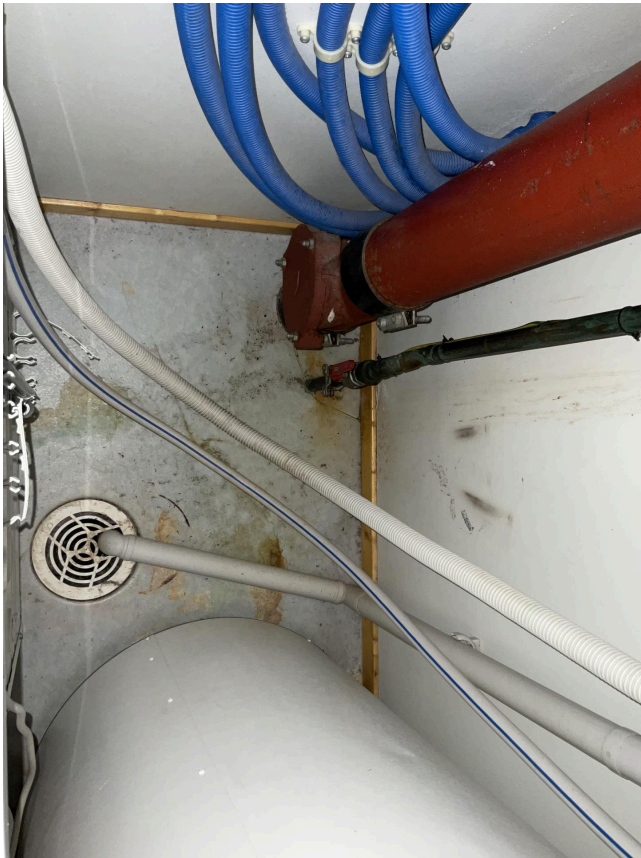
Stikkledninger på bod.
