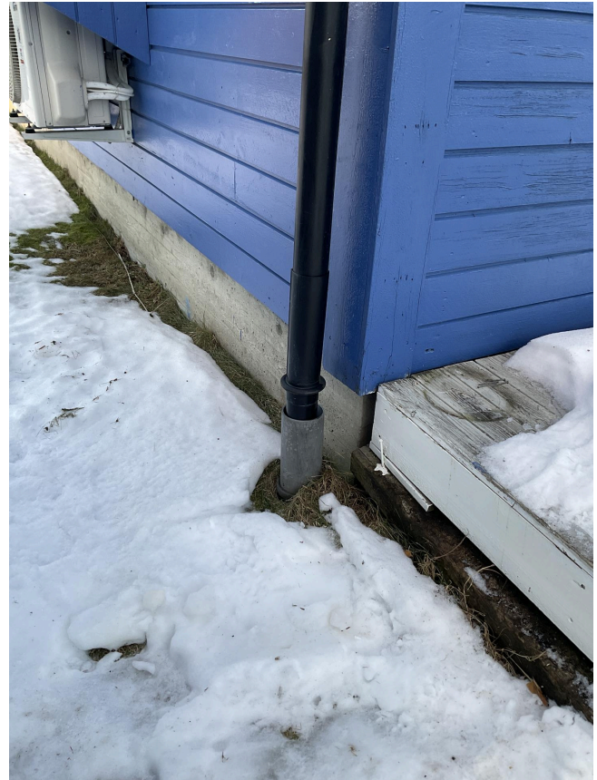
Taknedløp satt ned i grunnavløp, men ikke funksjonstestet
