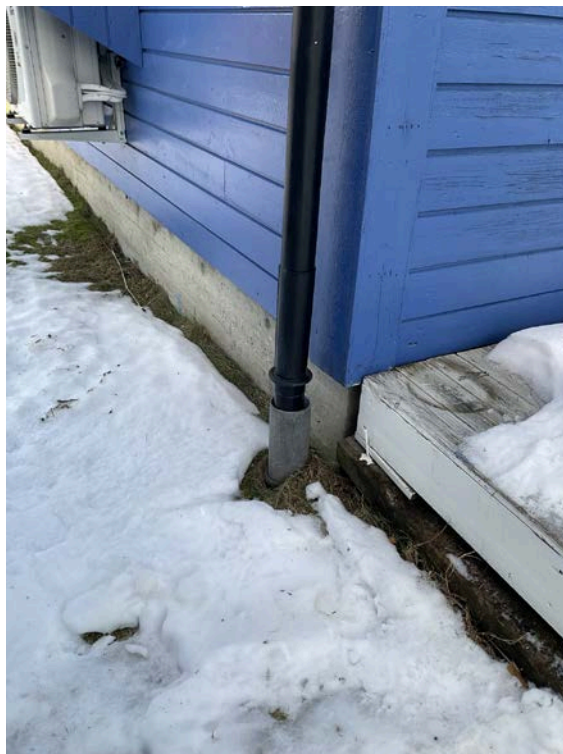
Taknedløp satt ned i grunnavløp, men ikke funksjonstestet
