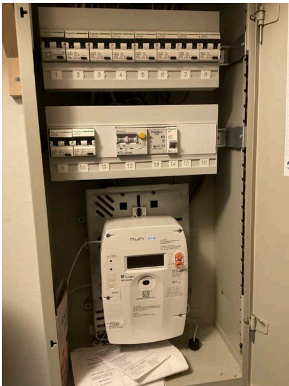
EI-skap med automatsikringer
