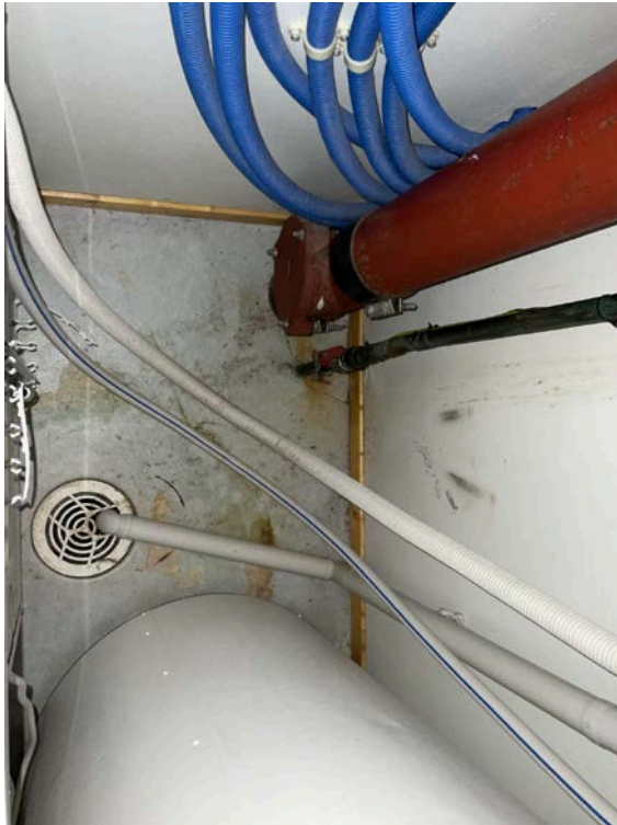
Stikkledninger på bod.
