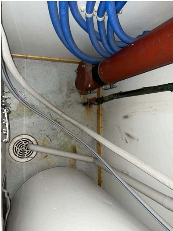
Bilde av soil avløpsrør og kobber vannrør m/ stoppekran
