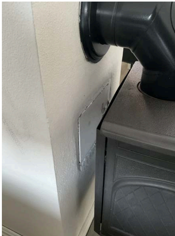
Bilde av feieluke bak vedovn.
