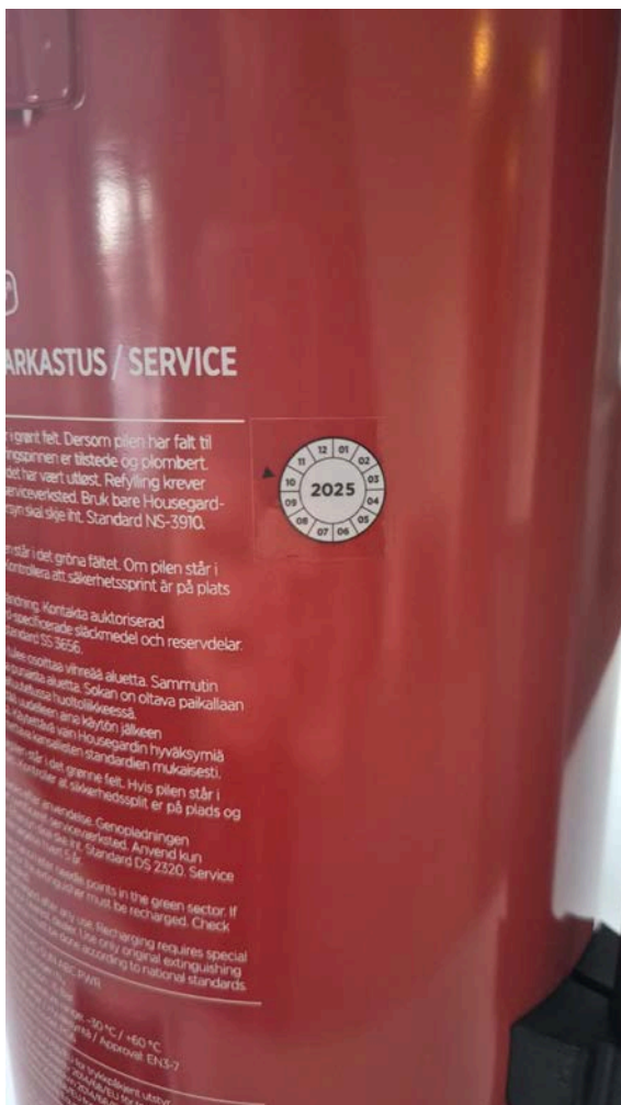
Pulverapparat fra 2025 plassert i bod
