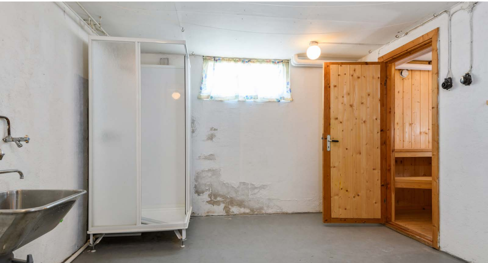
Bad/vaskerom i kjeller med støpt gulv og overflater med malt murpuss, antatt fra byggeåret. Rommet er utstyrt med dusjkabinett, utslagskum og sluk.
