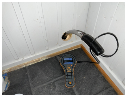
Målt fuktinnhold i bunnsvill på 26,1 vektprosent
