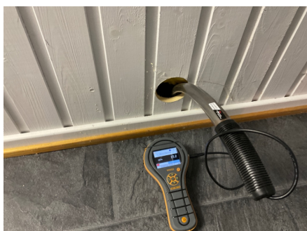
Målt fuktinnhold i bunnsvill på 23,2 vektprosent
