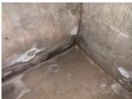
Saltutslag på vegg og gulv
