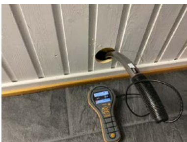
Målt fuktinnhold i bunnsvill på 23,2 vektprosent
