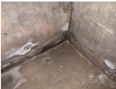
Saltutslag på vegg og gulv
