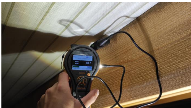
Begrenset ventilasjon i raft.
