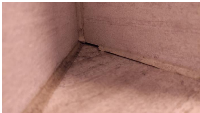
Drensåpning fra den innebygde sisternen.
