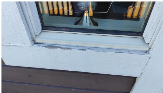
Manglende vannbrett på vindu.
