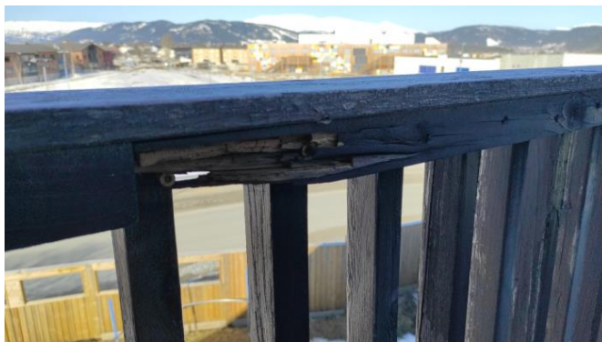
Råteskade i rekkverk.
