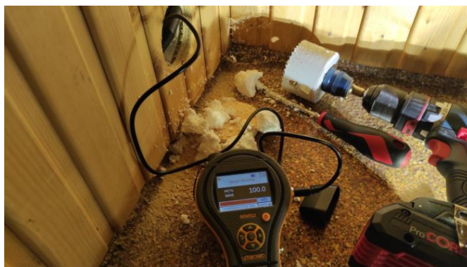
Fuktmåling i vegg mot dusjsone.
