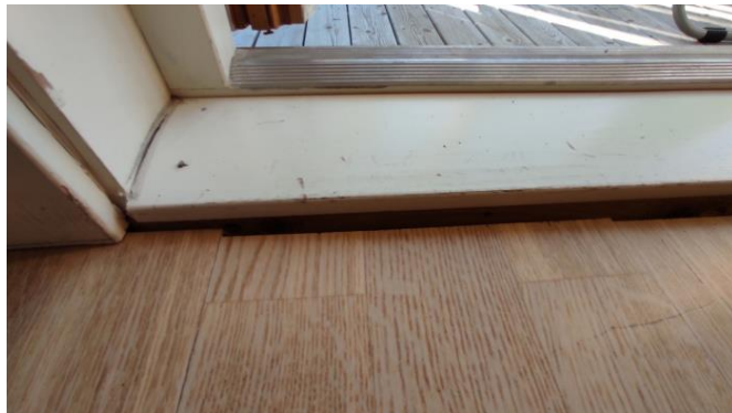
Ufagmessig avslutning av gulv.
