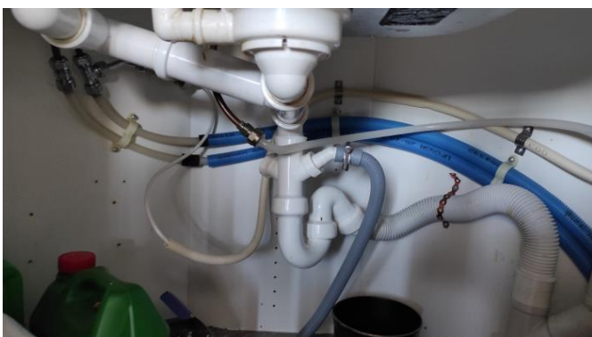
Kontroll etter lekkasjer.
