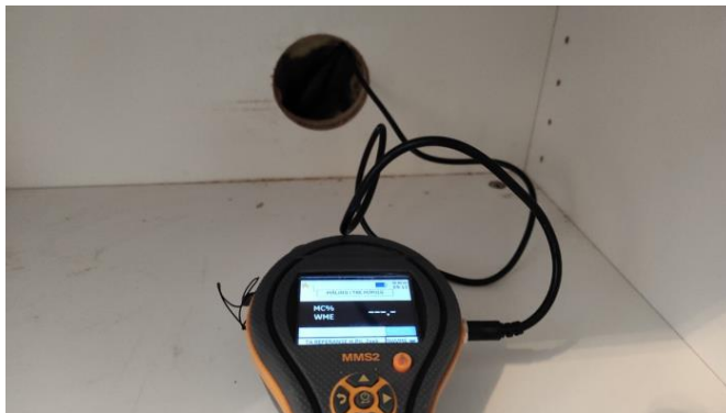
Fuktmåling i vegg.
