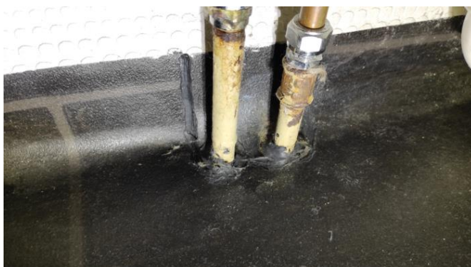
Ufagmessig og utett rørgjennomføring i gulv.
