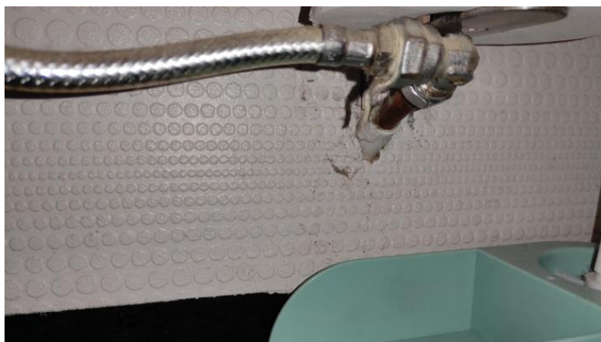
Utett rørgjennomføring i vegg.
