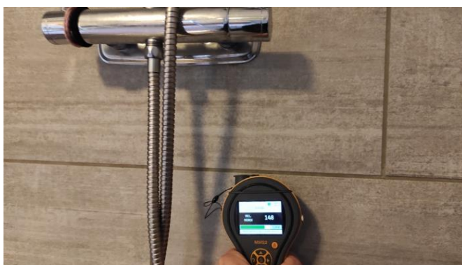
Fuktmåling i vegg.
