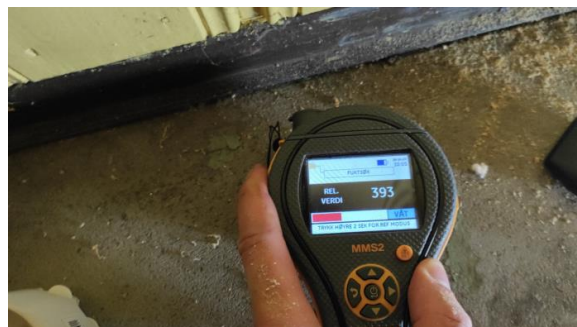
Fuktsøk med forhøyd fuktverdi.
