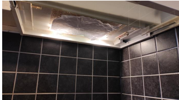
Funksjonstest av ventilator.
