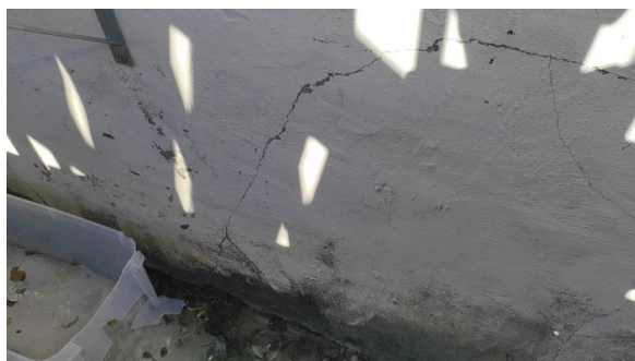
Riss i grunnmur.
