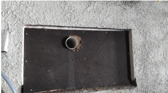
Avtrekk føres ut i uinnredet del i kjeller.
