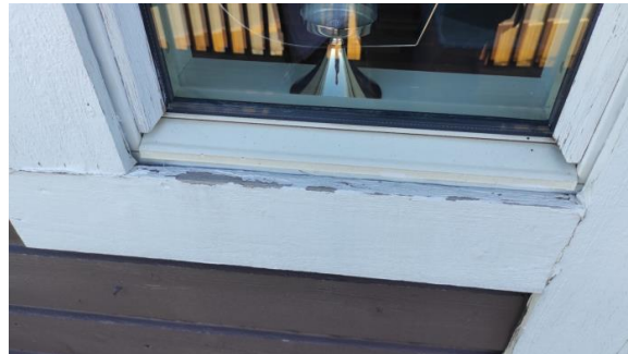
Manglende vannbrett på vindu.
