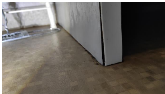
Fuktsvell i dekkplate.
