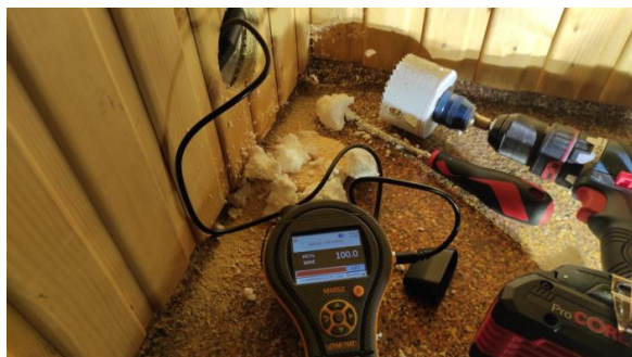
Fuktmåling i vegg mot dusjsone.
