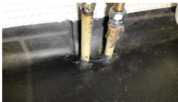
Ufagmessig og utett rørgjennomføring i gulv.
