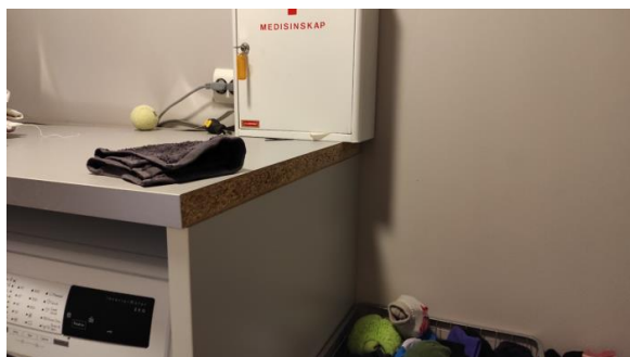
Manglende endelist på benkeplate.
