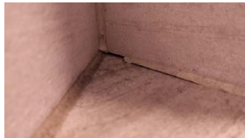
Drensåpning fra den innebygde sisternen.
