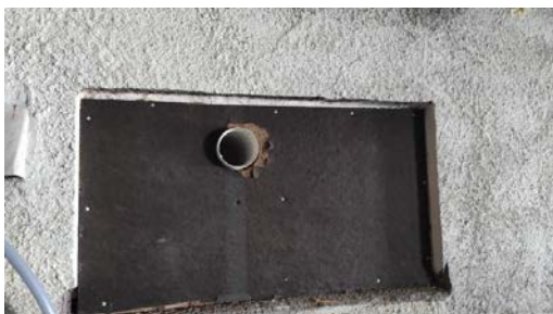
Avtrekk føres ut i uinnredet del i kjeller.
