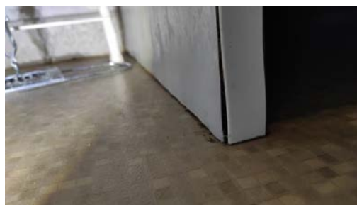
Fuktsvell i dekkplate.
