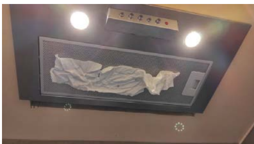
Funksjonstest av ventilator.
