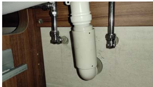
Manglende veggbokser for rørgjennomføring.
