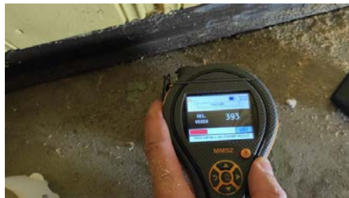
Fuktsøk med forhøyd fuktverdi.
