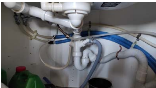
Kontroll etter lekkasjer.
