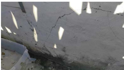
Riss i grunnmur.
