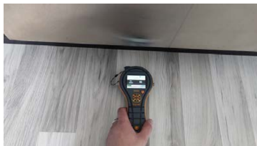
Fuktsøk ved oppvaskmaskin.
