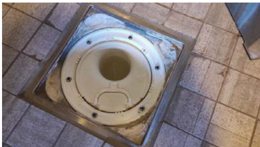
Deler av slukmansjetten er ikke smurt med membran.
