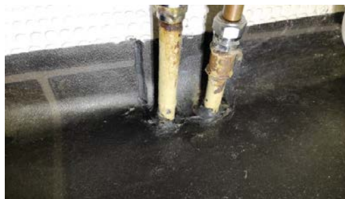
Ufagmessig og utett rørgjennomføring i gulv.
