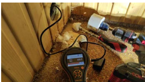
Fuktmåling i vegg mot dusjsone.
