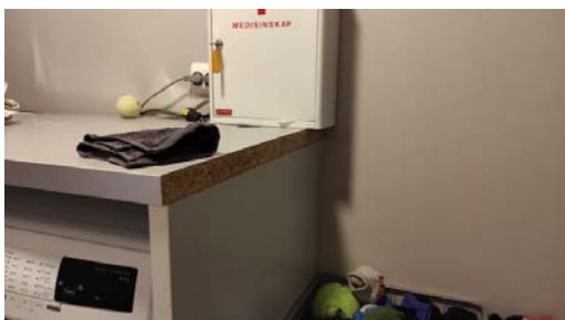
Manglende endelukk på benkeplate.
