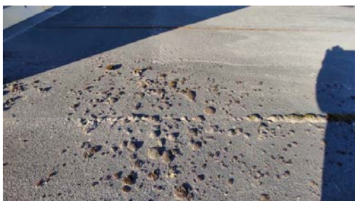
Stedvis mosegroing i taktekket.
