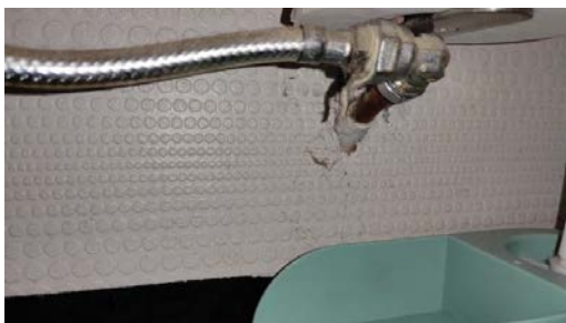
Utett rørgjennomføring i vegg.
