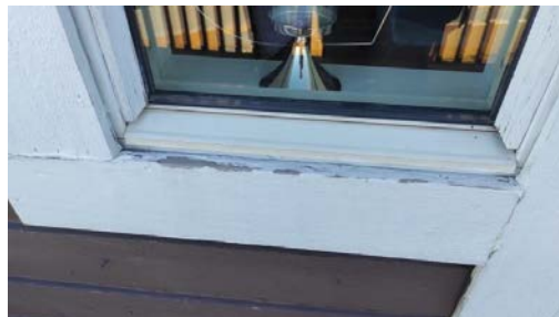
Manglende vannbrett på vindu.
