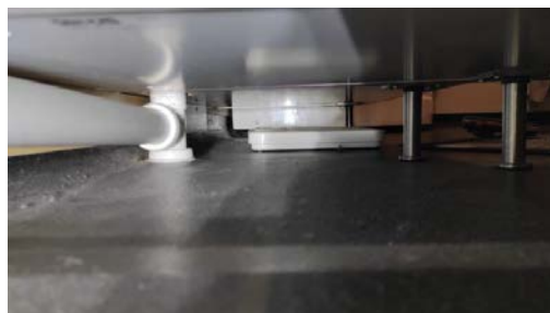
Sell i gulv under innredning.
