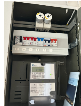
Sikringskap med automatsikringer.
