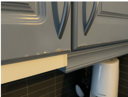
Svelling på overflater.
