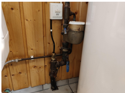
Stoppekran plassert på bad.
