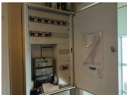
Sikringsskap plassert i entré.
