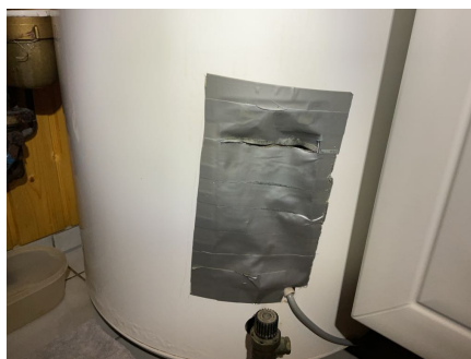
Deksel over el-kobling på varmtvannsbereder mangler.
