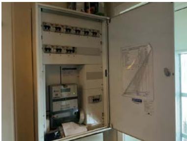
Sikringsskap plassert i entré.
