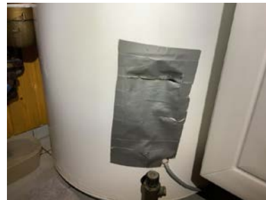
Deksel over el- kobling på varmtvannsbereder mangler.
