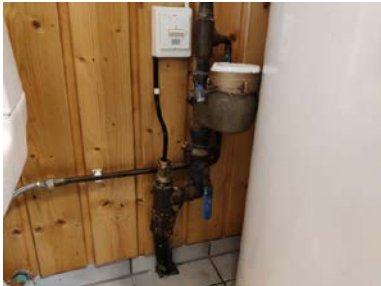
Stoppekran plassert på bad.
