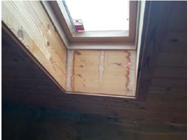
Kondensmerker/fuktmerker på enkelte vinduer.
