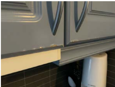
Svelling på overflater.
